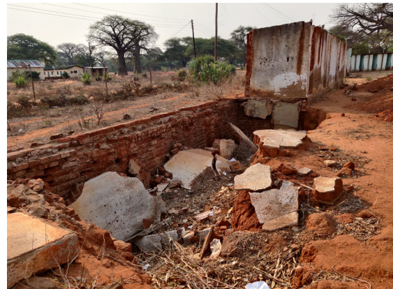
Durch den Zyklon Idai zerstörte Latrine an einer Schule.
